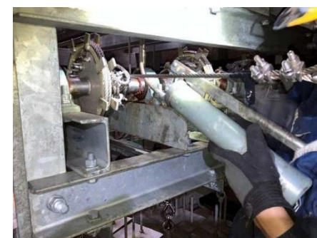
滑落防止装置 点検・グリスアップ
