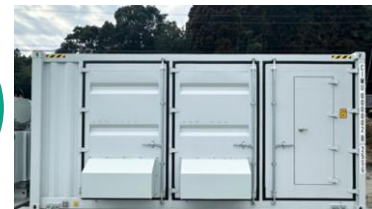
串間蓄電所 (宮崎県)
