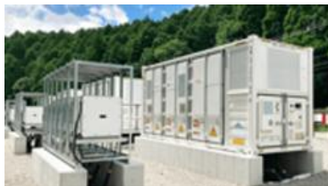
霧島蓄電所 (鹿児島県)
