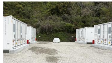
広島 三次蓄電所 (広島県)
