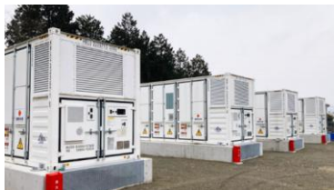
高鍋蓄電所 (宮崎県)
