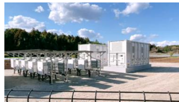
印西蓄電所 (千葉県)
