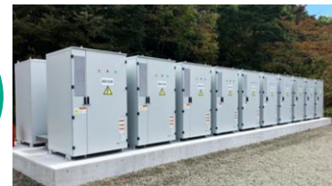
福島 二本松蓄電所 (福島県)
