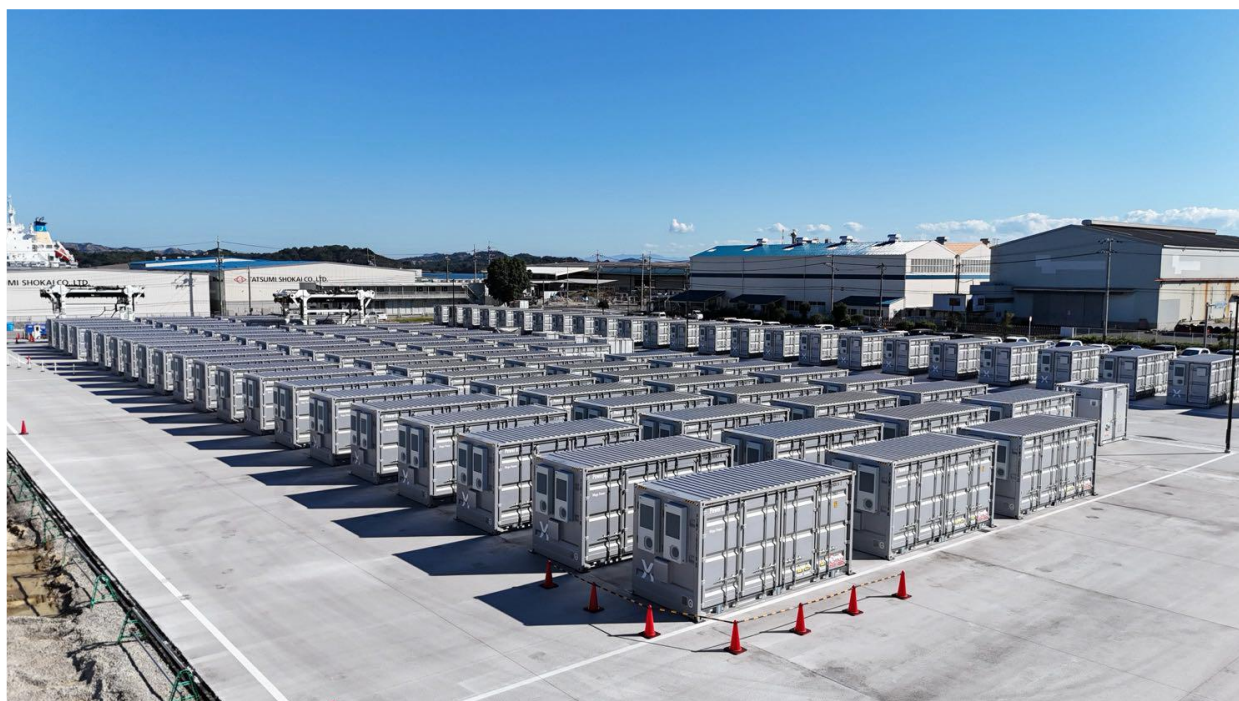
（画像：「Mega Power 2500」などの出荷前の蓄電システムを保管する本社工場のコンテナヤード）
